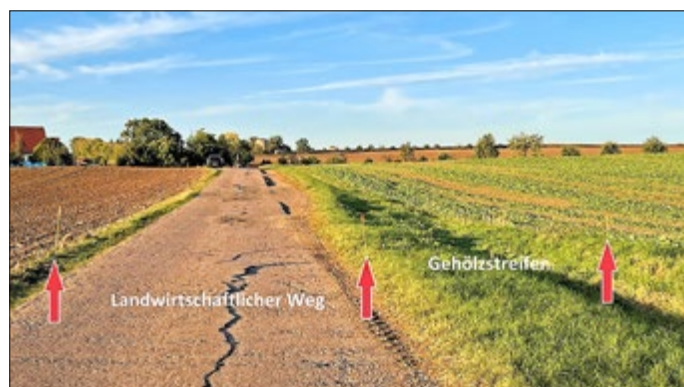
Der reparaturbedürftige Weg und der geplante Streifen für die verlängerte Baumreihe
